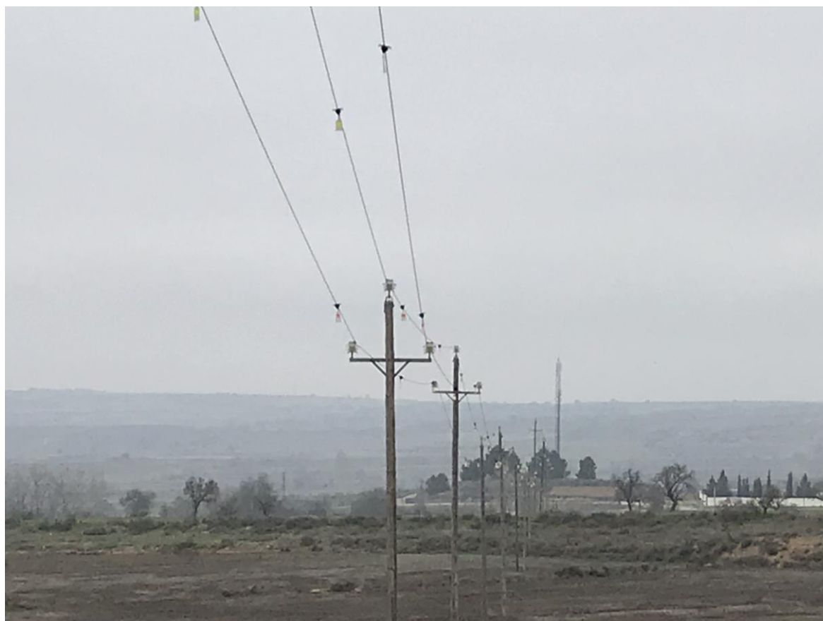
Imagen 63. Fotografías de alineación y los apoyos anteriores al apoyo 16: apoyos en cruz
