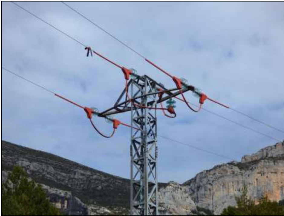
Fig. 3: Como medida preparatoria se adecuaron las dos derivaciones de propiedad particular próximas al lugar de liberación. Se ampliaron las distancias accesibles de seguridad y se protegieron con materiales preformados todos los puentes y elementos en tensión que podían suponer algún riesgo para las aves.
