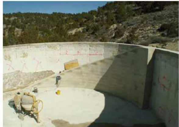
Fuente de las Blancas (La Puebla de San Miguel). Instalación de una rampa de escape en un depósito antincendios.
