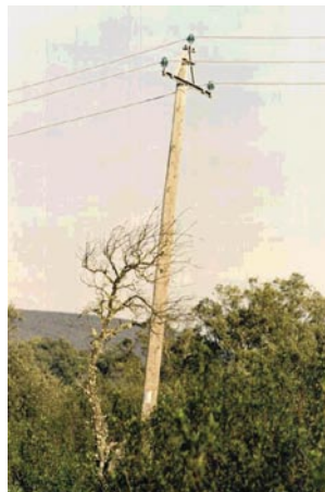
Foto 1. Poste tradicional de Distribución
