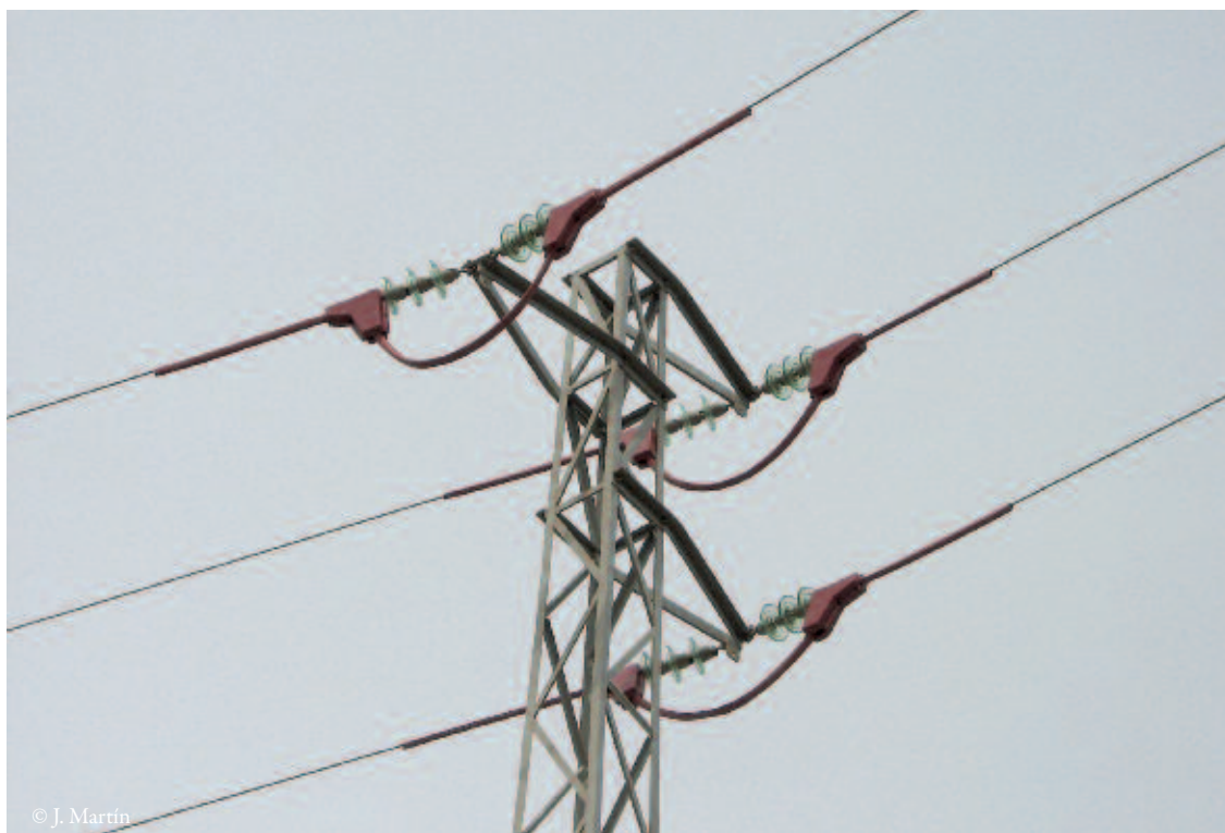
Figura 21. Ejemplo de aislamientos de conductores para prevenir la electrocución de aves en apoyos del tendido eléctrico utilizados en Andalucía.
