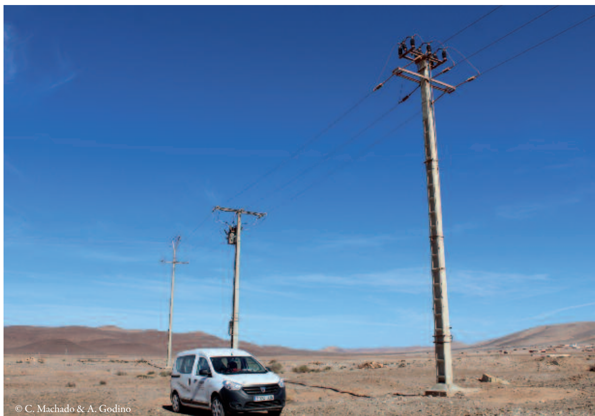
Figura 7. Seccionador y apoyo con transformador en vástago en la Línea E.
