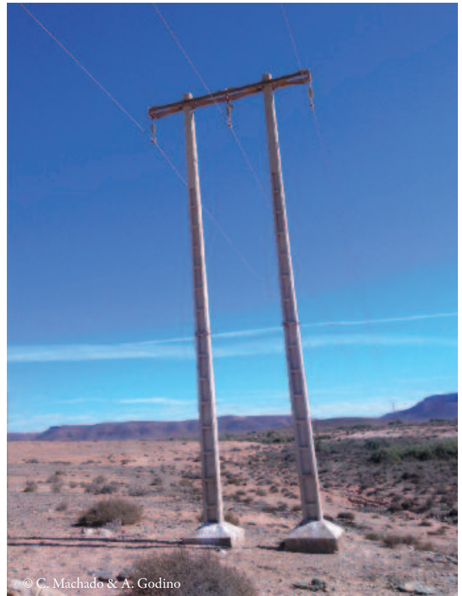
Figura 32. Apoyo tipo P-03, con doble poste (pórtico) de hormigón (A-125).
