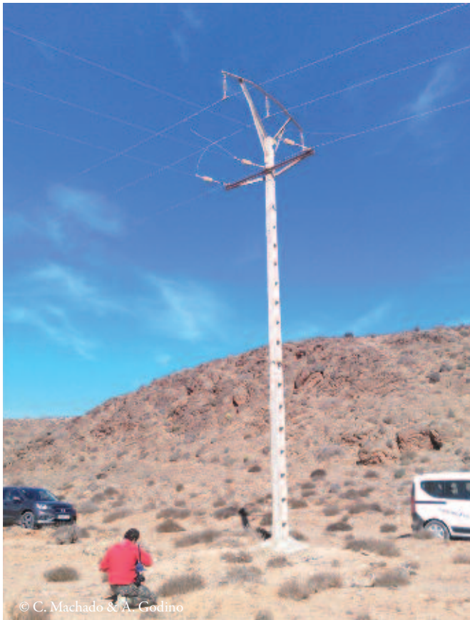
Figura 31. Apoyo tipo P-02 con derivación (A-105). Junto a este apoyo se encontraron los cadáveres de tres águilas-azor perdiceras ( Aquila fasciata ).
