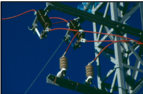
Material termorretráctil utilizado para aislar los puentes a fusibles y autoválvulas
