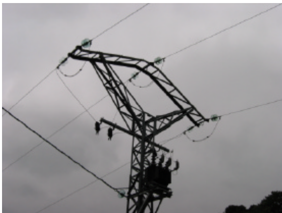
28D BÓVEDA Amarre+transformador
