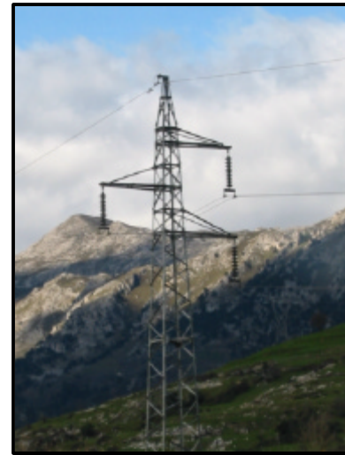
Línea de 132 Kv., posee un cable de tierra en la parte superior
