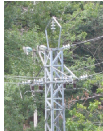
22E MONTAJE 1 AMARRE INFERIOR Metálico+farolillo+derivación+seccionador
