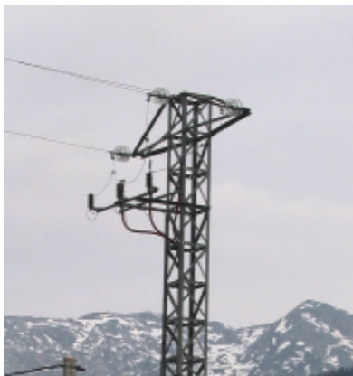
57 MONTAJE 1 AMARRE INFERIOR Metálico+autoválvulas+subterráneo
